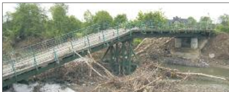
Zniszczony most w Boczowie.
