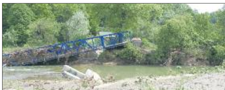
Zniszczona kładka na drodze Łapanów – zalew.
