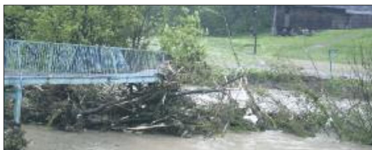
Kładka w Łapanowie po powodzi.
