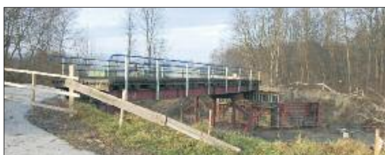
Most w Tarnawie przed remontem.
